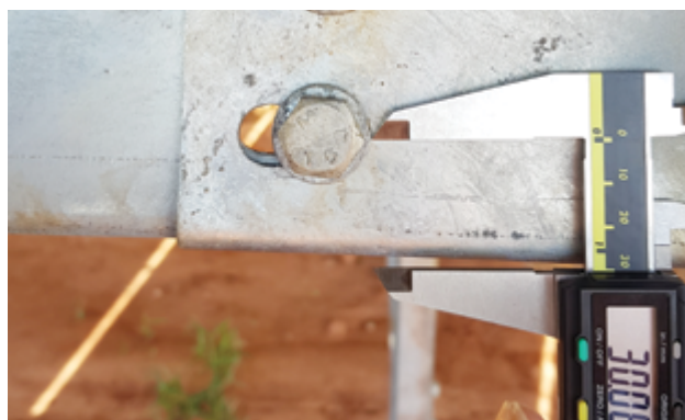
Imagem 49. Exemplo de identificação das peças de medição para situação com erro de fabricação (furação).
